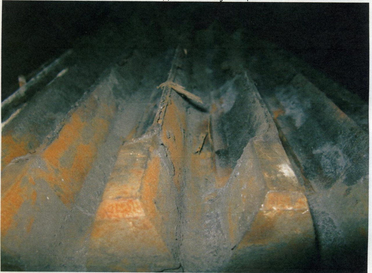
Состояние не обработанной ТС ТМ НИОД приводной шестерни углеразмольной мельницы Ш-50 блок № 4 А после вывода из эксплуатации
